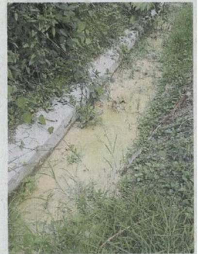
斜坡旁的沟渠长年堵塞，引来蚊虫。
